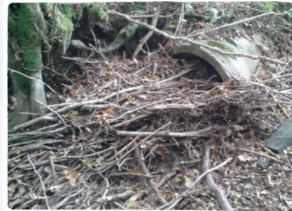
Buse bouchée par l'amas de branches sur le ruisseau de la Souchardrie - Crédit photo : M. Douane
