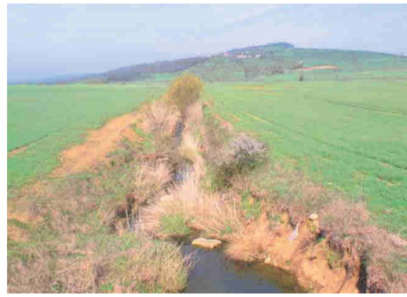
Exemple d'érosion de berge en zone agricole
